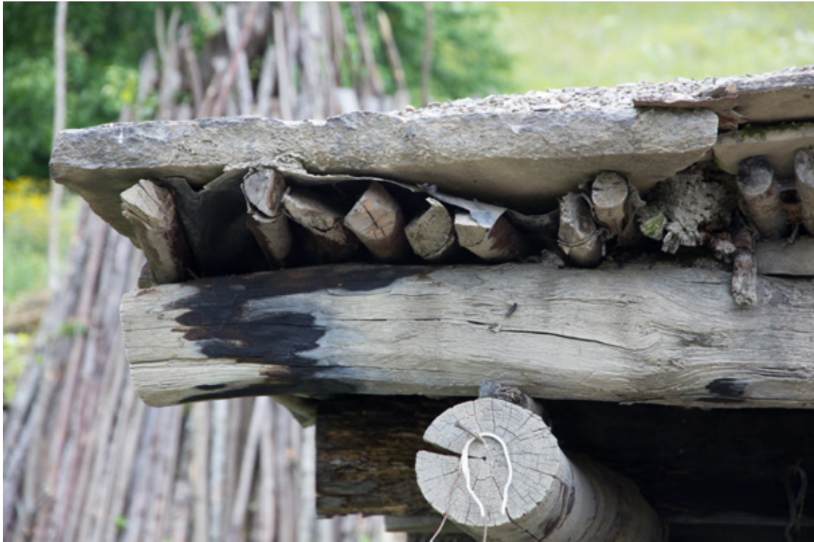
სურ. 51. გაგა არაბულის ტრადიციული სახლი, მუხისა და ვერხვის ძელებით გაკეთებული სახურავის დეტალი. ბარისახო, ხევსურეთი.
